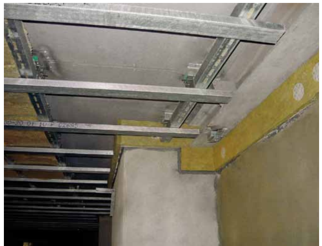
Atypický detail návaznosti akustického podhledu na okolní stěny – osazení pruhu z těžké minerální izolace
